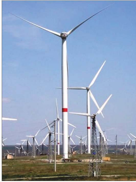
Рис.А.5 – Новоазовська вітрова електростанція (за [138, 76])
