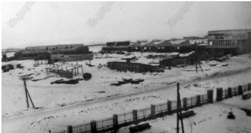
Вид з другого поверху центральної частини корпусу А на внутрішній двір комуни в період будівництва фотозаводу; на задньому плані зліва направо: будівництво виробничих корпусів фотозаводу, виробничий корпус інструментального заводу, заводоуправління (фото із експозиції Державного музею-заповідника А. С. Макаренка в с. Ковалівка Полтавського району)
